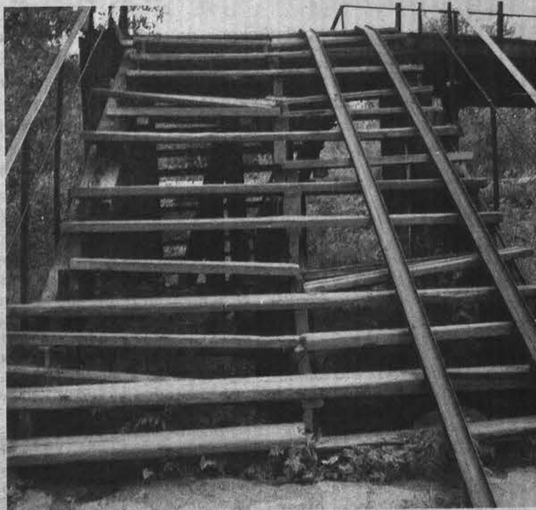
Детям в школу, а трап в аварийно-опасном состоянии.
