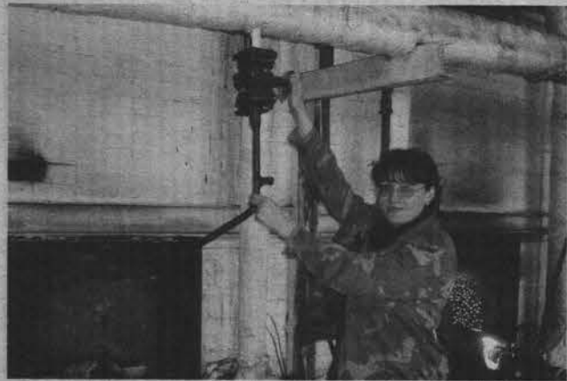
За бесперебойной работой котельной поселка Щукозеро следит оператор-машинист Надежда Ермоленко.
