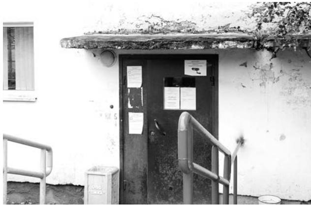
Козырек нужно срочно заменить, пока он не разрушился окончательно.
