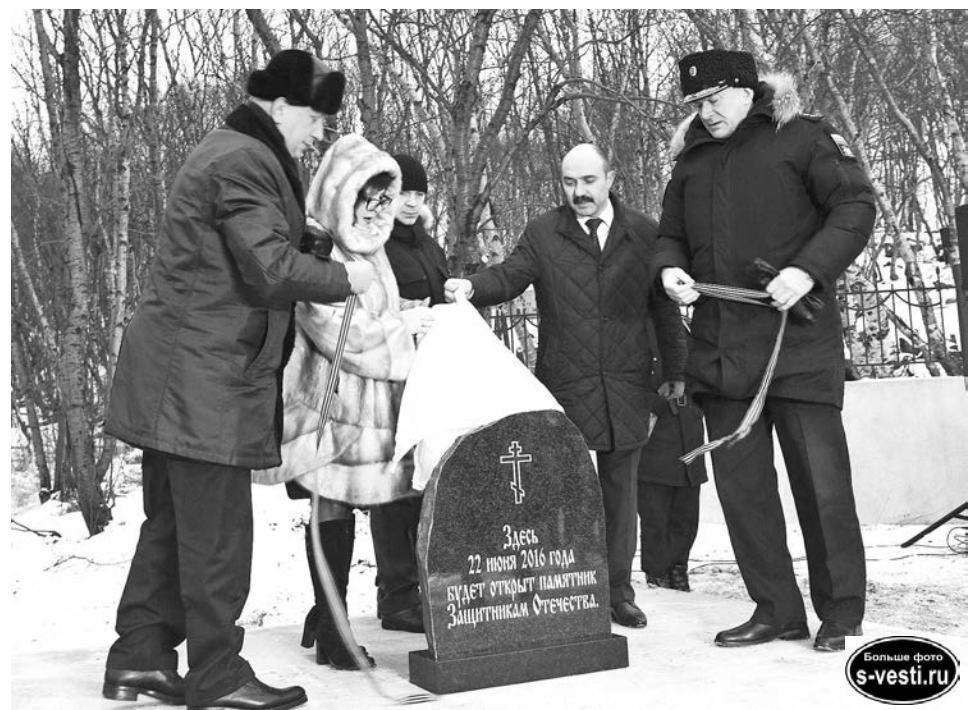
Почетное право открытия закладного камня было предоставлено Александру Безверхнему, Ирине Норинной, Игорю Бабенко и Николаю Евменову.
