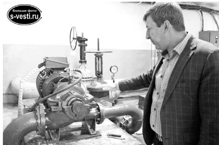
Александр Каменев: «КПД нового насосного оборудования выше, чем у старого, прослужившего четверть века».
