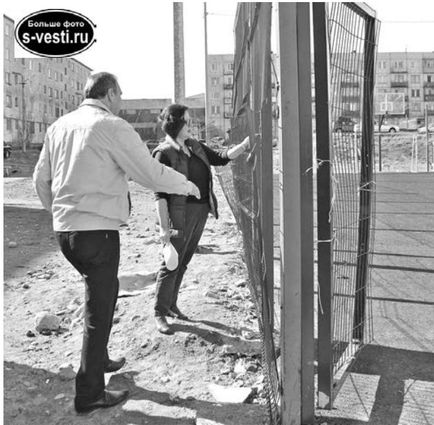
Ограда спортплощадки на Гвардейской пока держится, а на Пионерской и Северной Заставе несколько секций уже падали.
