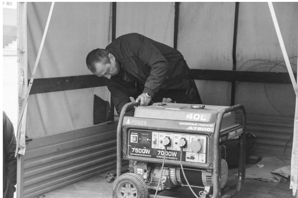
Подача электроэнергии на участках в случае отключения должна быть обеспечена за счет мобильного генератора.
