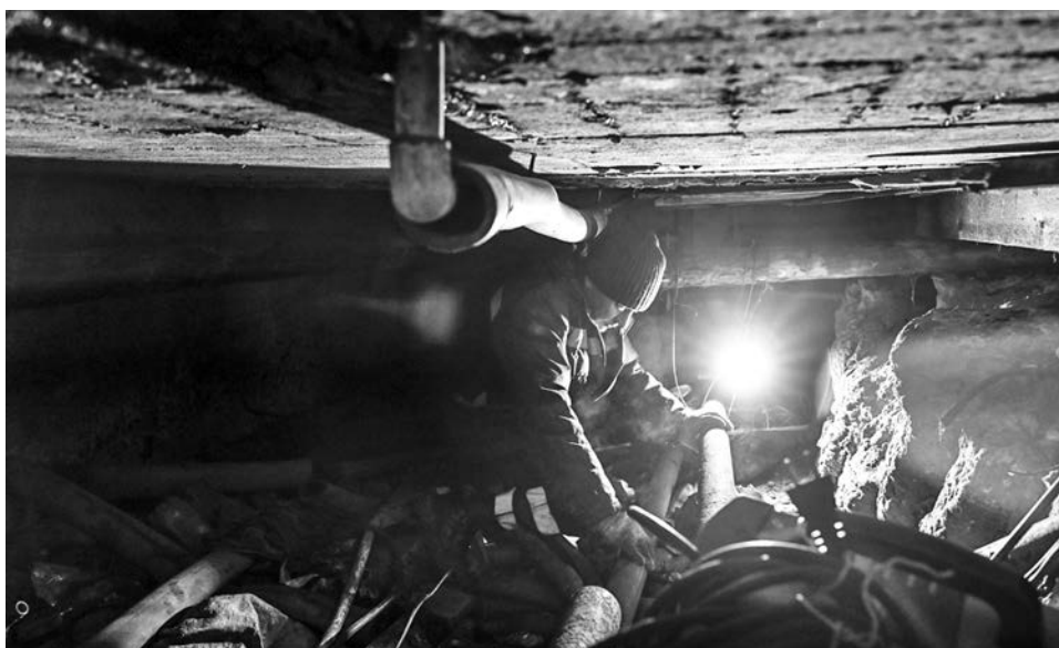
Застывшие трубы в подвалах жилых домов по ул. Школьная прогревались слесарями вручную газовыми горелками.
