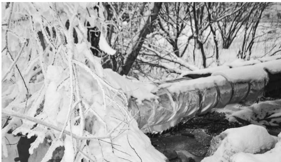
Первый порыв наземной теплотрассы в пгт Сафоново в районе ул. Школьной, 15, был ликвидирован к 14 января.
