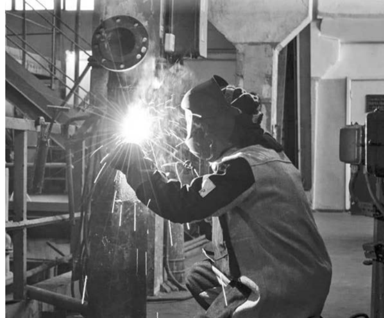
Надежность городского теплоснабжения зависит от своевременной модернизации оборудования котельных.
