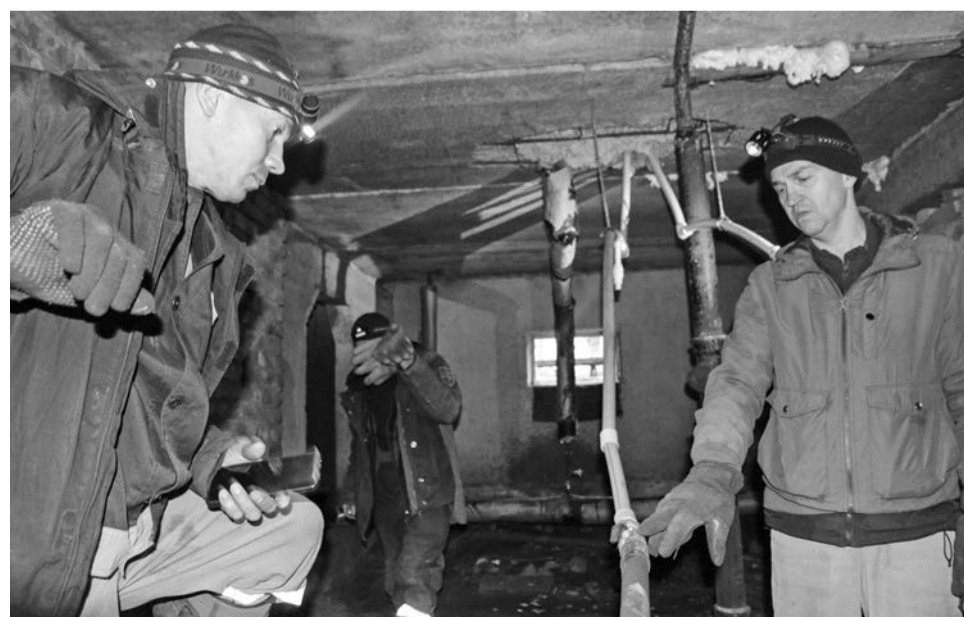
Бригада МУП «Североморскводоканал» осматривает подвал, чтобы оценить масштаб предстоящих работ в доме №18 на улице Корттик.
