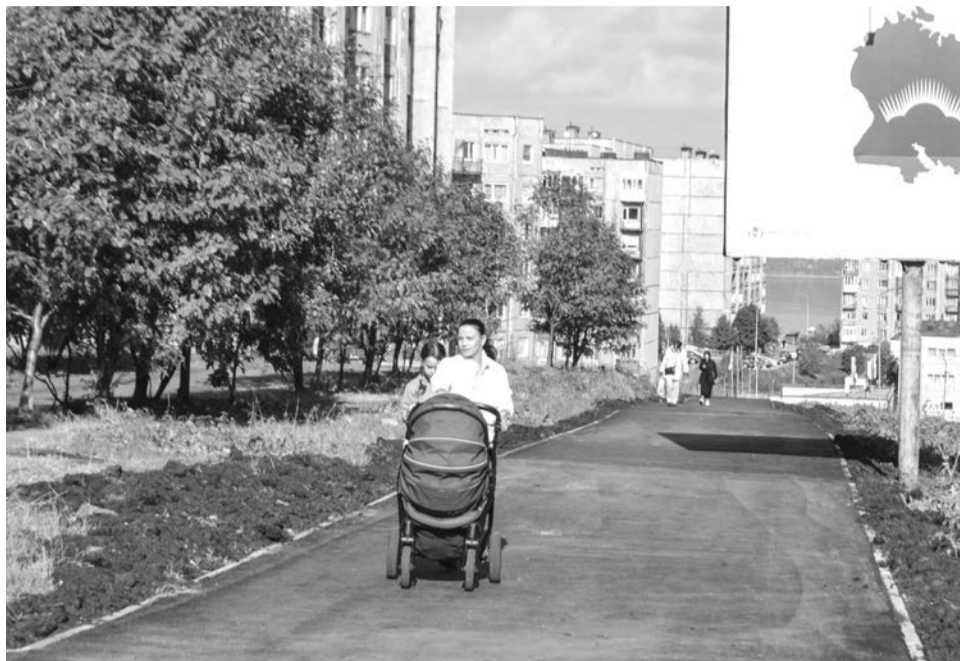
Новое асфальто-бетонное покрытие на проезжей части и тротуаре ул. Вице-адмирала Падорина было уложено в рамках программы реновации ЗАТО.
