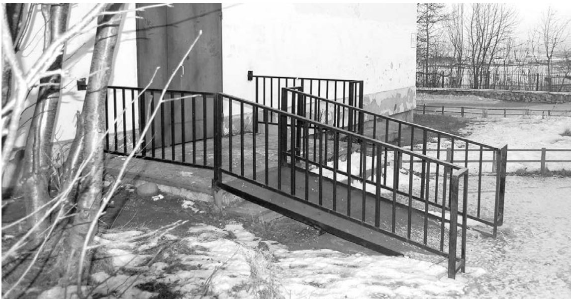
В седьмой школе пандусом предусмотрительно оборудовали отдельный вход. Это позволит детям с ограничениями здоровья попасть в школу без помех.
