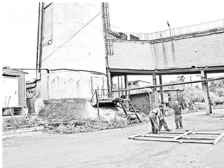
На этой неделе специалисты «СМО «Ладога» собирали леса. Их установят на высоте почти 90 м, чтобы добраться до верхней кромки трубы.
