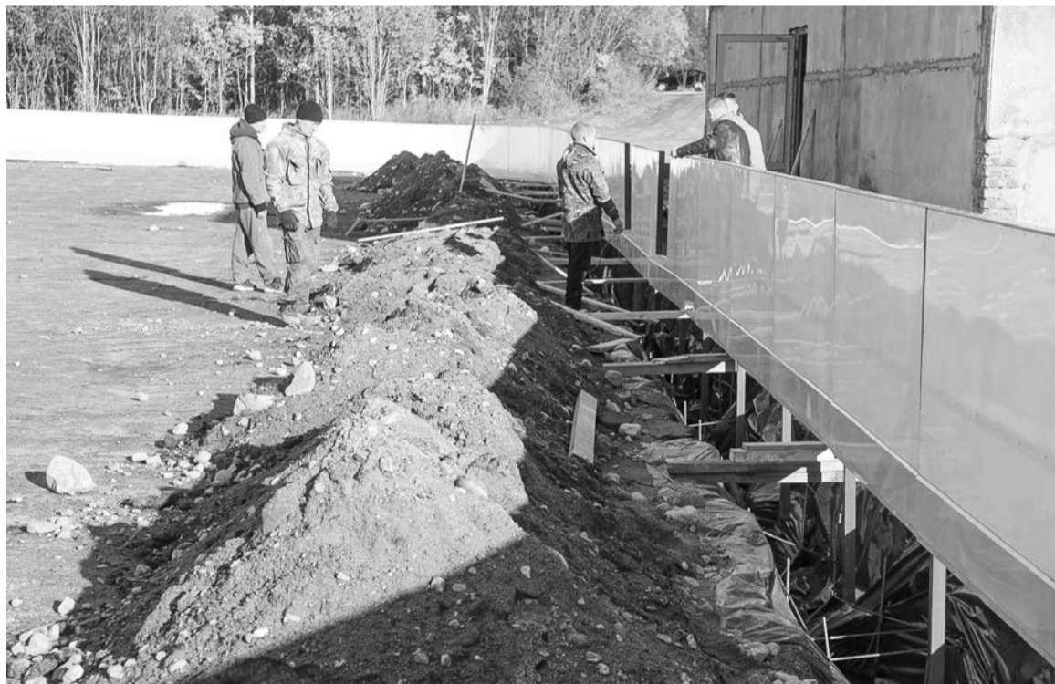
Борта хоккейного корта в п. Сафоново установлены, теперь в их основание заливают бетон.
