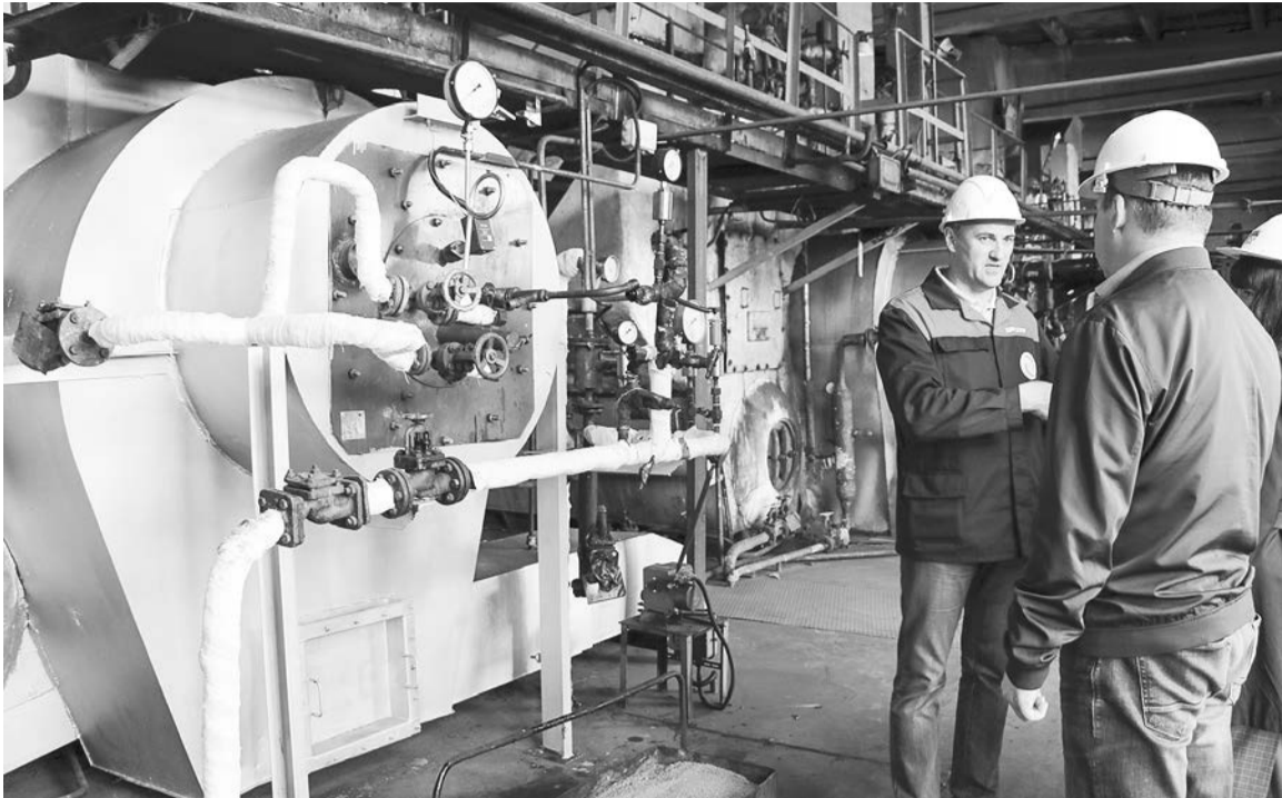
Текущий ремонт на теплоцентралях необходим для того, чтобы в зимний период не было форс-мажоров. О ходе работ, которые ведутся сейчас, Олегу Прасову рассказал Александр Кобытев.
