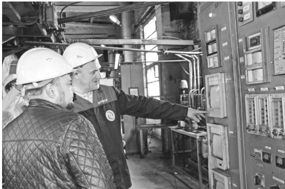
Александр Кобытев демонстрирует Сергею Лупанскому работу оборудования.
