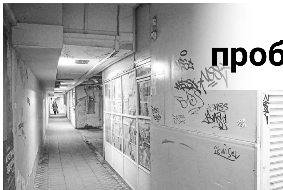
Подземный переход на ул. Северная Застава явно нуждается в наведении порядка.
