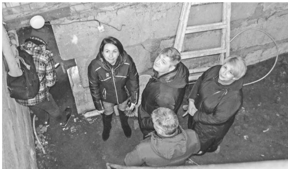
Участники мунконтроля пожалели, что не взяли резиновые сапоги: пройти в подвал дома №21 по ул.Адм. Сизова можно только в них.
