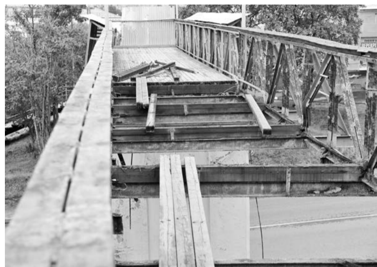
Коррозия металла выявилась при вскрытии настила. Теперь требуется частичная замена несущих конструкций.
