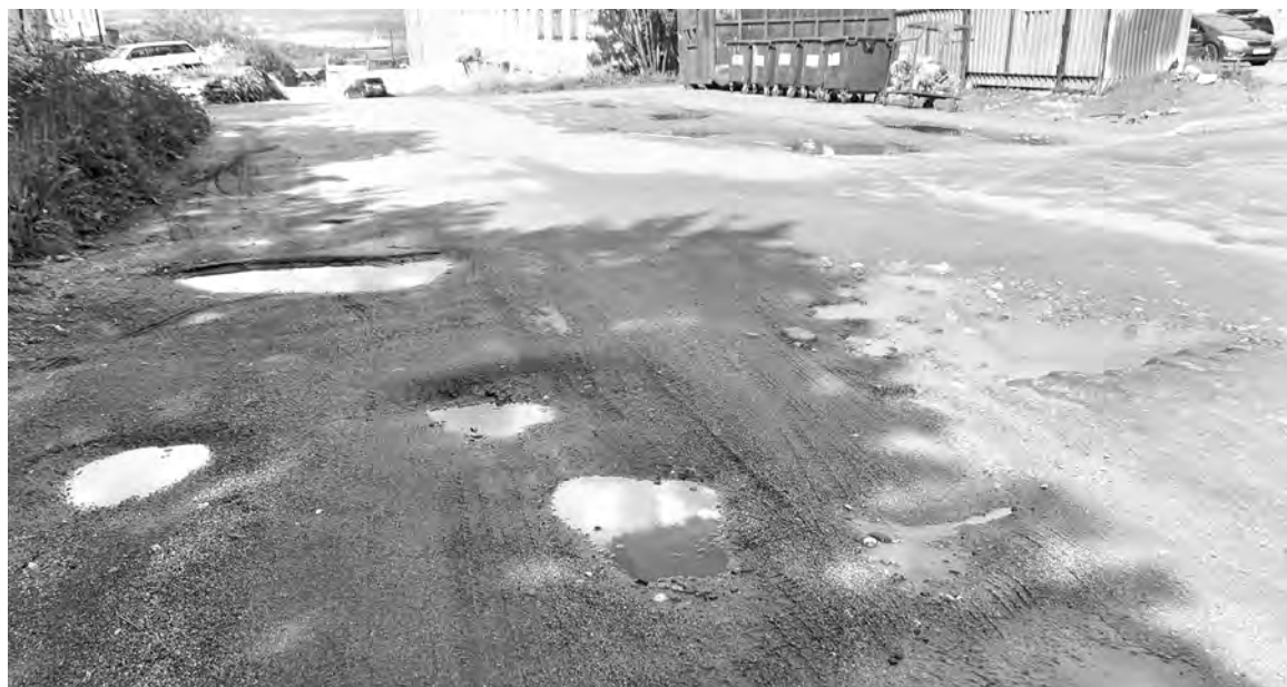
После дождя эти ямы между домами №5 и 29 на ул.Комсомольской превращаются в огромную лужу, скрывающую опасность для автомобилистов.
