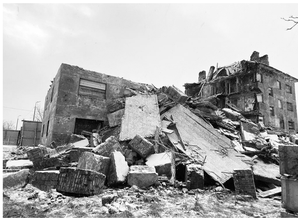
Помимо сноса здания, контрактом предусмотрены вывоз строительного мусора и восстановление почвенно-растительного слоя.
