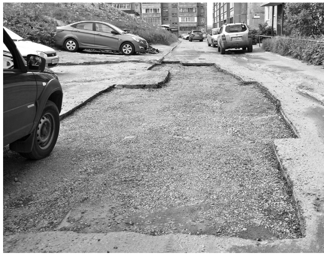
Качество ямочного ремонта во дворах часто вызывает нарекания со стороны жителей.
