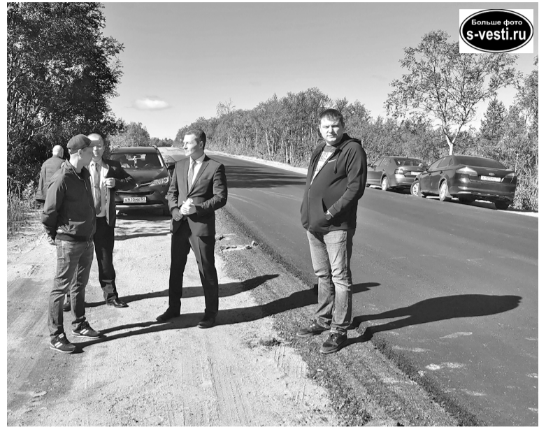
Ремонт дороги в районе озера Ондатрового проверили Константин Ухарев, председатель КРГХ Руслан Кучерявый, Андрей Федулов и начальник участка Максим Любимцев.
