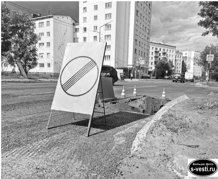
Провал на повороте с ул. Душенова на ул. Головки - результат проводимых работ.
