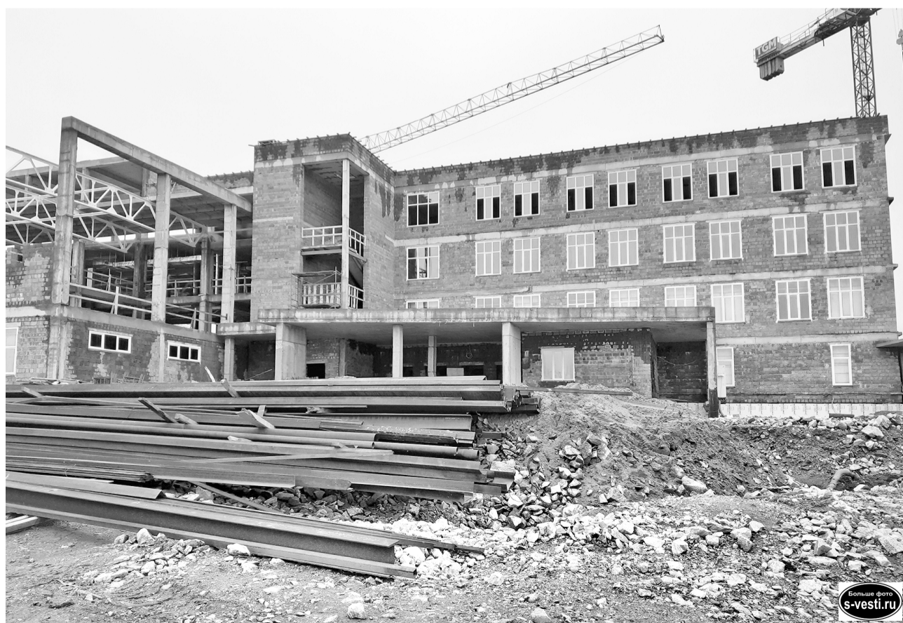
Строительство идет параллельно: где-то заканчивается первый этаж, где-то ставятся окна, подводятся коммуникации. Например, в первом блоке уже выстроен 4-й этаж, оттуда открывается замечательный вид на город.
