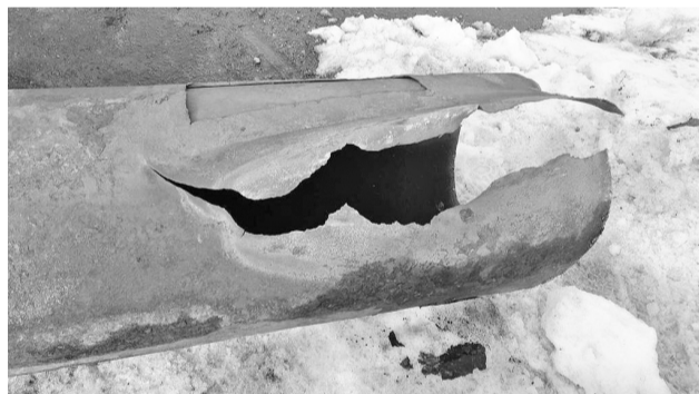
Прорыв на главном стволе теплотрассы, снабжающей теплом и горячей водой «Верх города».
