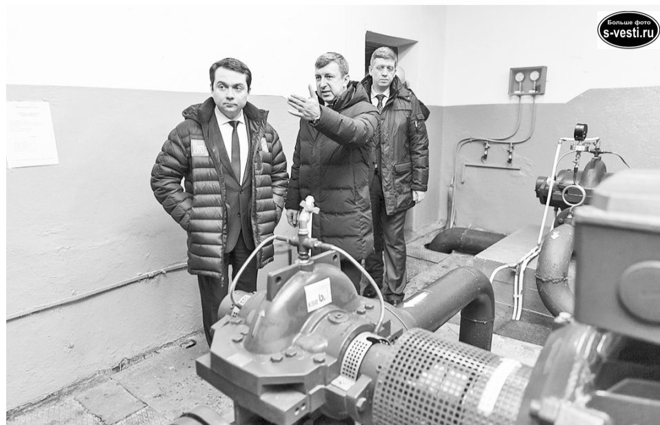
Александр Каменев рассказал Андрею Чибису о специфике работы насосной станции.
