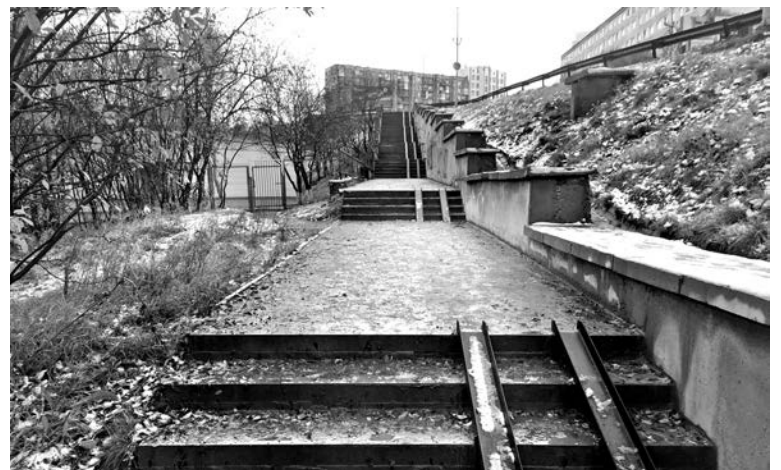
Бетонное покрытие трапа на ул. Гаджиева себя не оправдало, его сменит деревянное.
