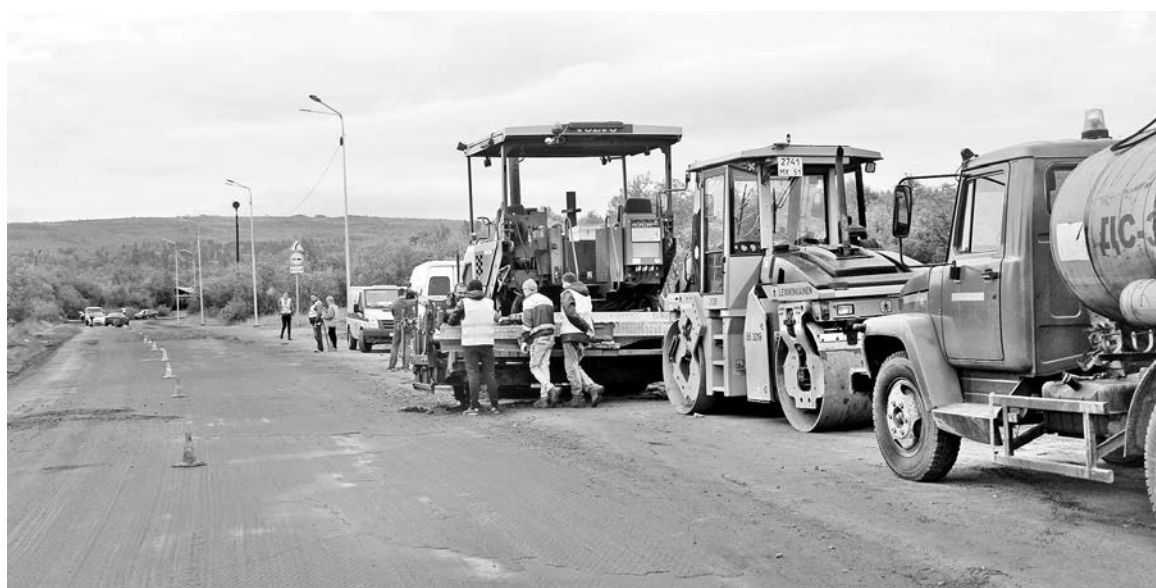
На ремонт 4-х участков автодорог в нашем ЗАТО было выделено почти 45 млн. руб. На сэкономленные после проведения конкурентных процедур деньги планируется отремонтировать еще 1000 м 2 асфальтового покрытия.
