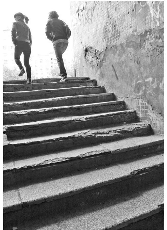
Те, кому регулярно приходится спускаться и подниматься по лестнице в переходе на ул.Кирова, ждут не дождутся ее ремонта.
