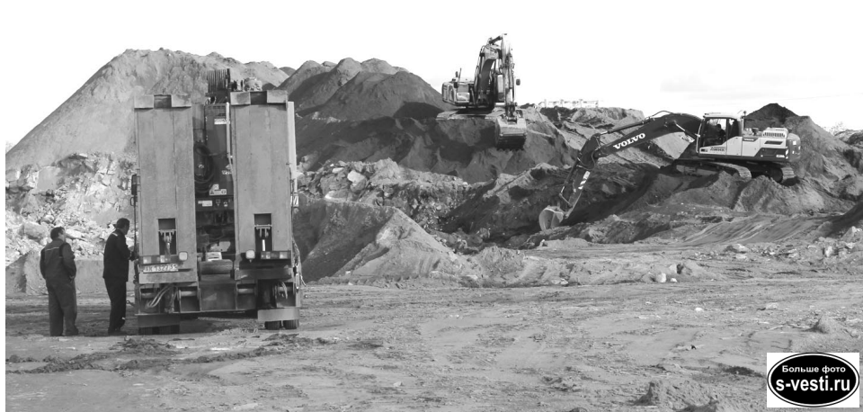
Именно на том месте, где сейчас орудуют экскаваторы, будет расположено здание школы.
