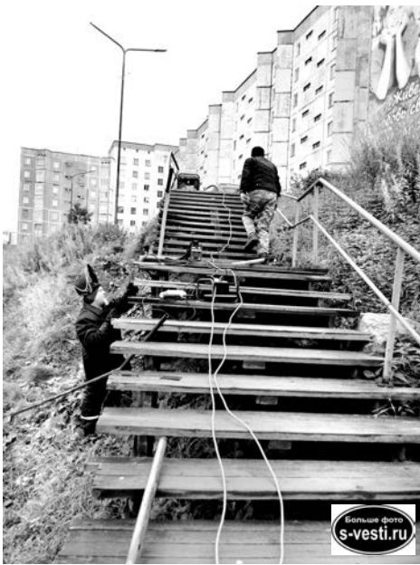
Трап на ул.Сизова частично отремонтировался не раз - металлические и деревянные заплата видны повсюду.
