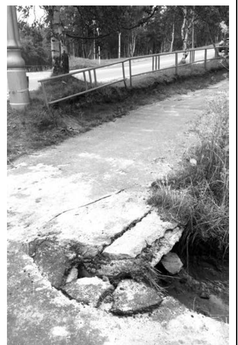
На ул.Душенова, 10, треснул асфальт.
