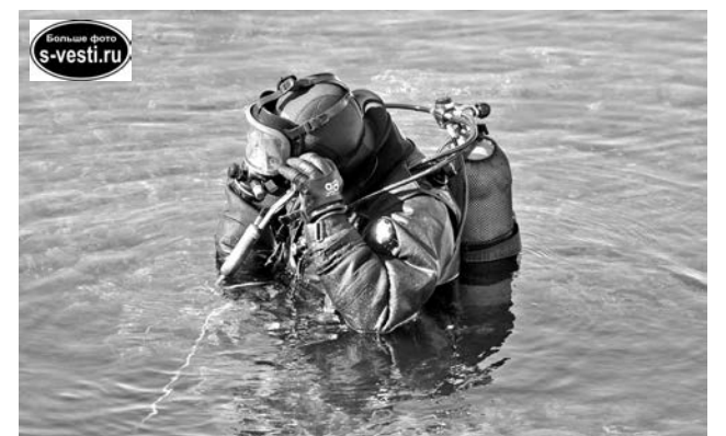
Водолаз с использованием экзотермической установки «BROCO», которая обеспечивает температуру горения на конце электрода 5500 градусов, прорезал под водой технологические отверстия для крепления тросов.
