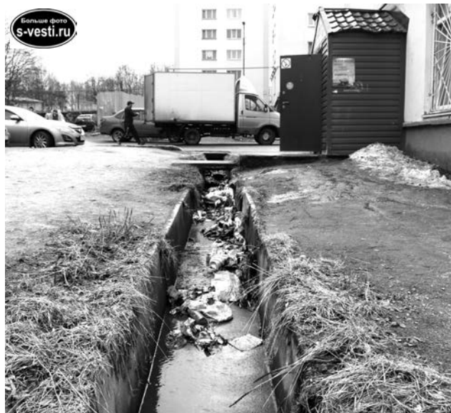
На Колышкина, 7, мусор складывают в ливневке, хотя недалеко контейнерная площадка.
