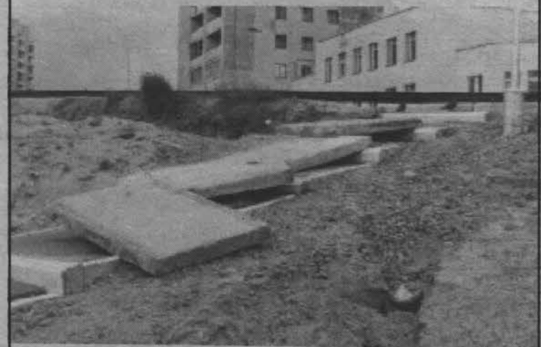
А это - недобросовестные рабочие, бросившие многотонные плиты на пешеходной дорожке, по обеим сторонам которой оставлены два незасыпанных котлована. Ни проехать, ни пройти...
