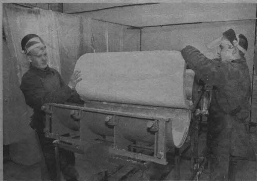
Выемку готовой изоляционной скорлупы из формы производят работники участка вспомогательного производства Денис Малицкий и Сергей Забуруин.
