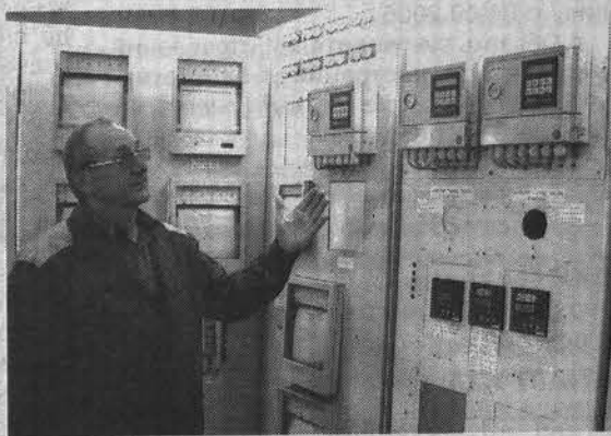
За работой приборов контроля и учета теплоэнергии следит начальник смены 1 района МУП СПТС Александр Бобров.
