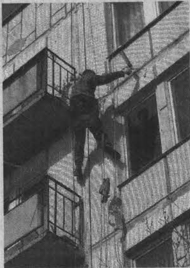
Какой ремонт дому необходимо теперь, будут решать сами жильцы.
